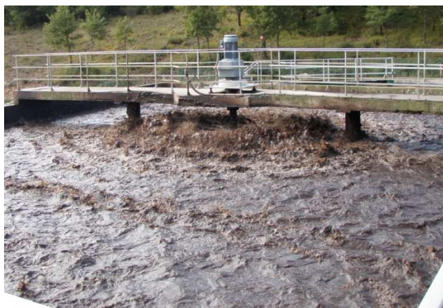
Aération par turbine
